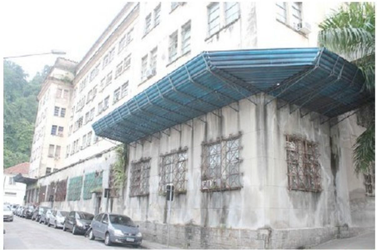
Teve que ser colocada proteção para evitar queda de alvenaria do prédio na cabeça de pedestres que circulam pelo entorno
