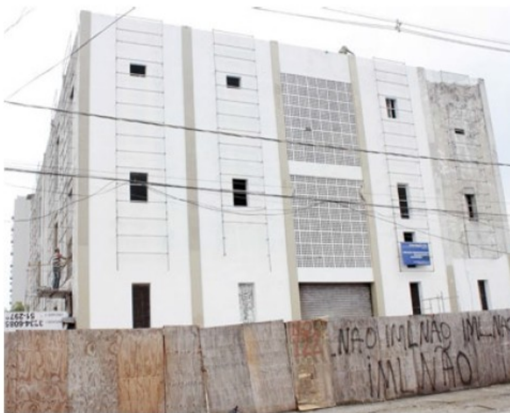
Ontem, praticamente duas pessoas trabalhavam no prédio em reforma que poderá sediar o IML.
