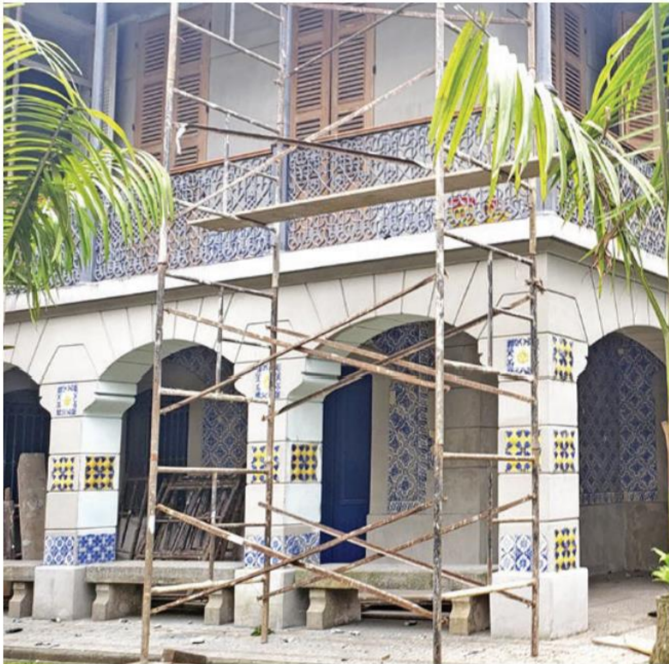
Foi assinada infração por execução de obras sem licença e aplicada multa. A obra só poderá ser retomada após o atendimento da intimação
