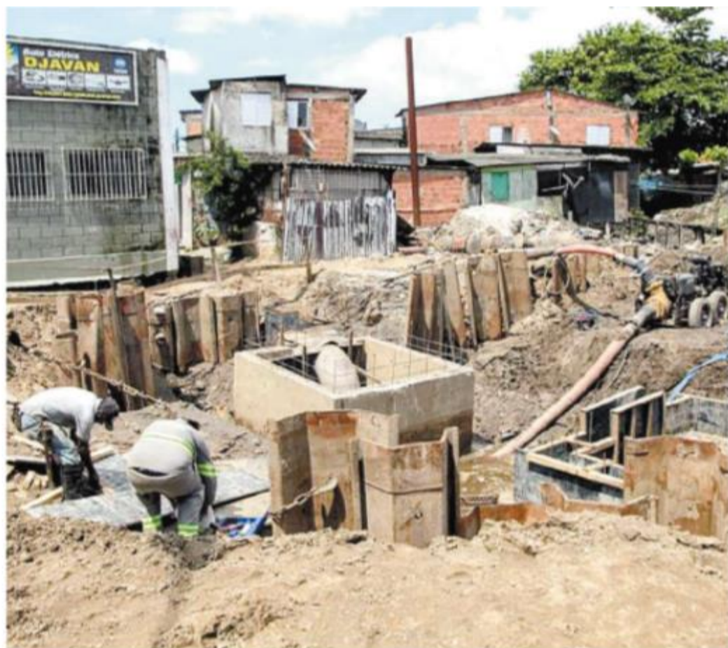
Obras foram realizadas no Castelo para remanejar tubulações antes da construção da estação elevatória
