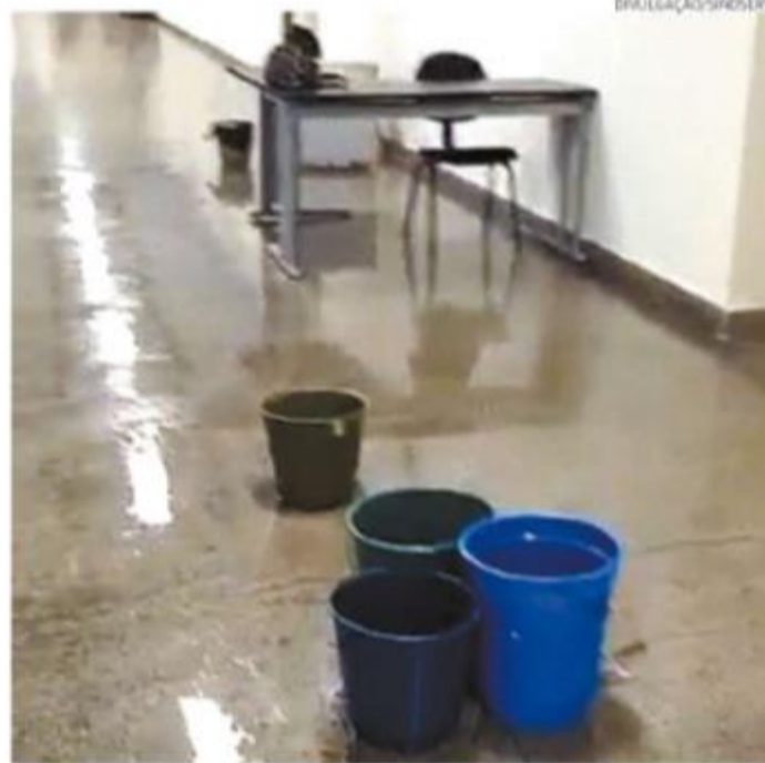
Andradas II, na Aparecida, tem goteiras, e água se acumula no piso
