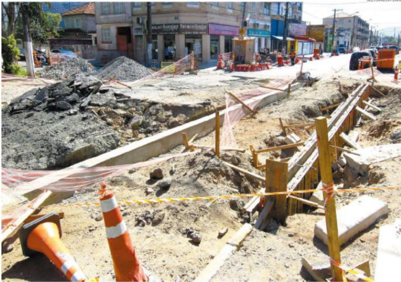
O segundo trecho do VLT, que ligará a Estação Conselheiro Nébias ao Valongo, no Centro, terá mais uma etapa de obras a partir de hoje
