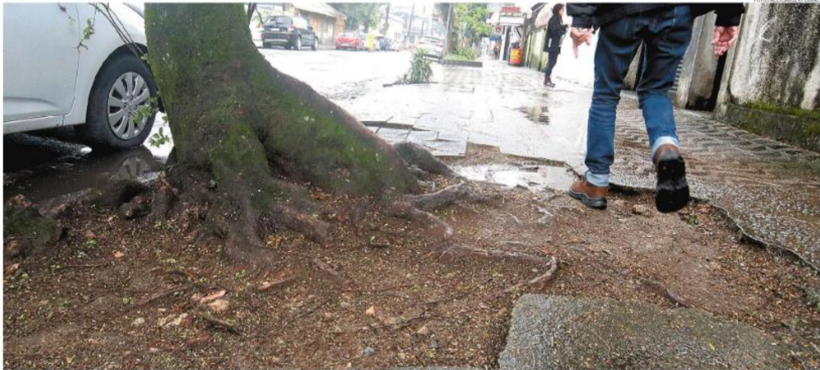
Devem ser atendidas 50 áreas onde ocorreram remoção de árvores e raízes, com danos às calçadas; investimento na recuperação do calçamento será de R$ 457 mil até o final deste ano, informa a Prefeitura
