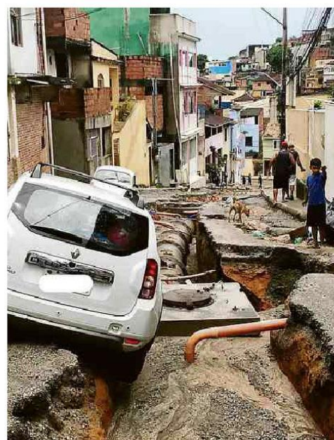
Cratera aberta no meio de uma rua no morro São Jorge, em Macaé, no Norte Fluminense, após chuvas Federico Mesquita/InterTV
