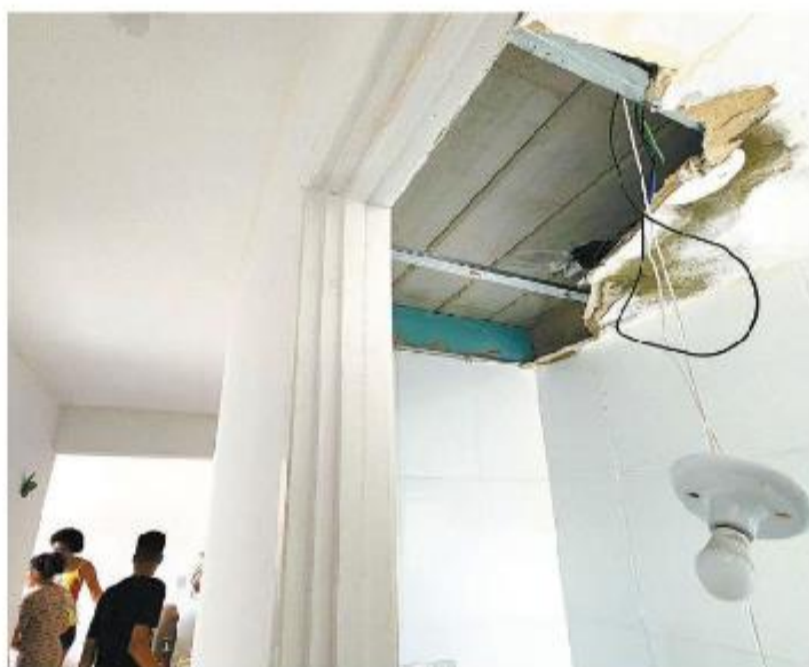
Na segunda-feira, parte do teto do banheiro de um apartamento caiu
