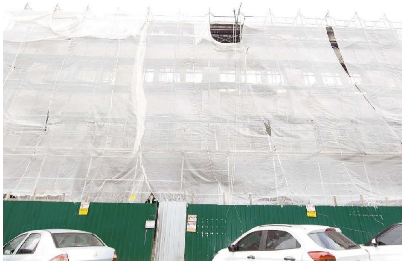
Reforma da construção, na Praça Iguatemi Martins, na Vila Nova, foi dividida em três etapas. A primeira, em andamento, é na parte externa
