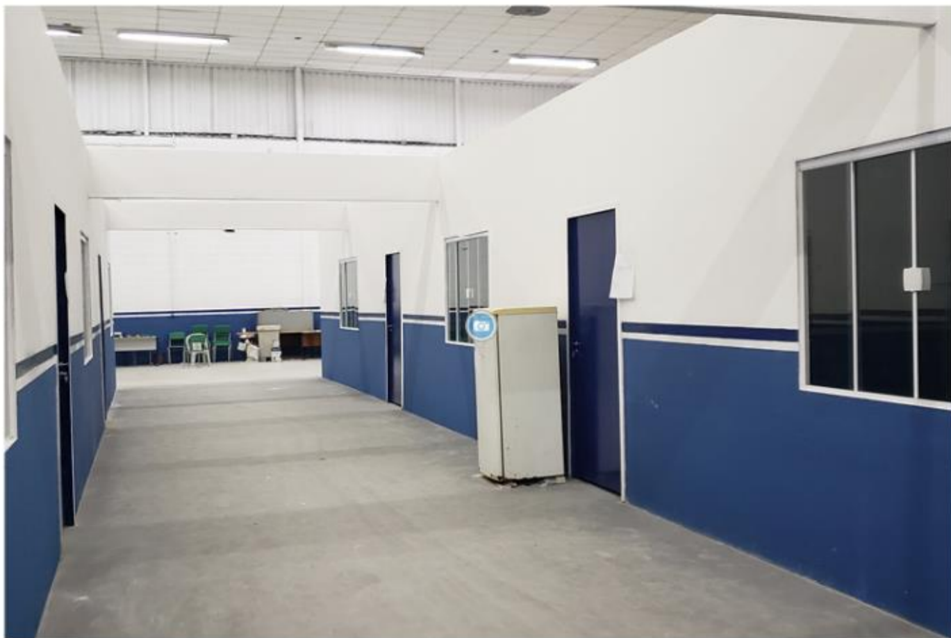
As janelas das salas abrem para o interior do galpão, portanto, não entra ar renovado para as crianças, segundo os pais e mães dos alunos
