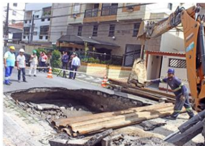
Cratera se abriu na madrugada na Rua Goiás e feriu motoqueiro
