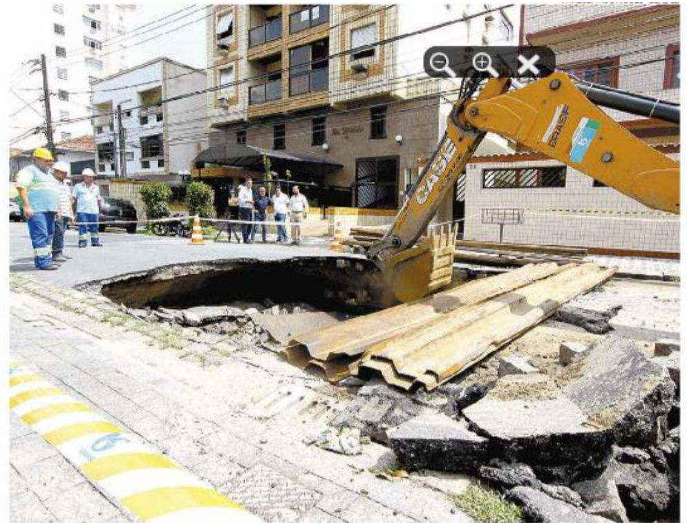
O mais recente buraco na Rua Goiás, no Boqueirão, se abriu por volta das 2 horas de quinta-feira
