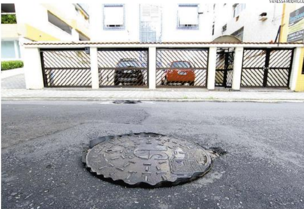
A Sabesp “está analisando a condição da pavimentação”. Tampões receberam borracha e serão corrigidos
