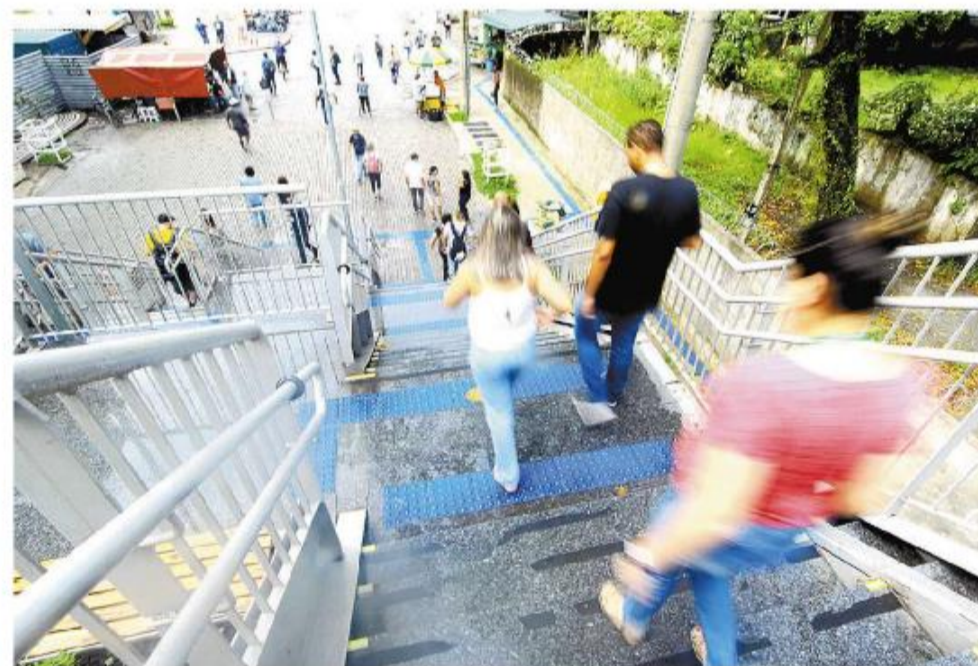
Usuários citam rachaduras e desgaste do piso antiderrapante, pois temem acidentes na escadaria, íngreme
