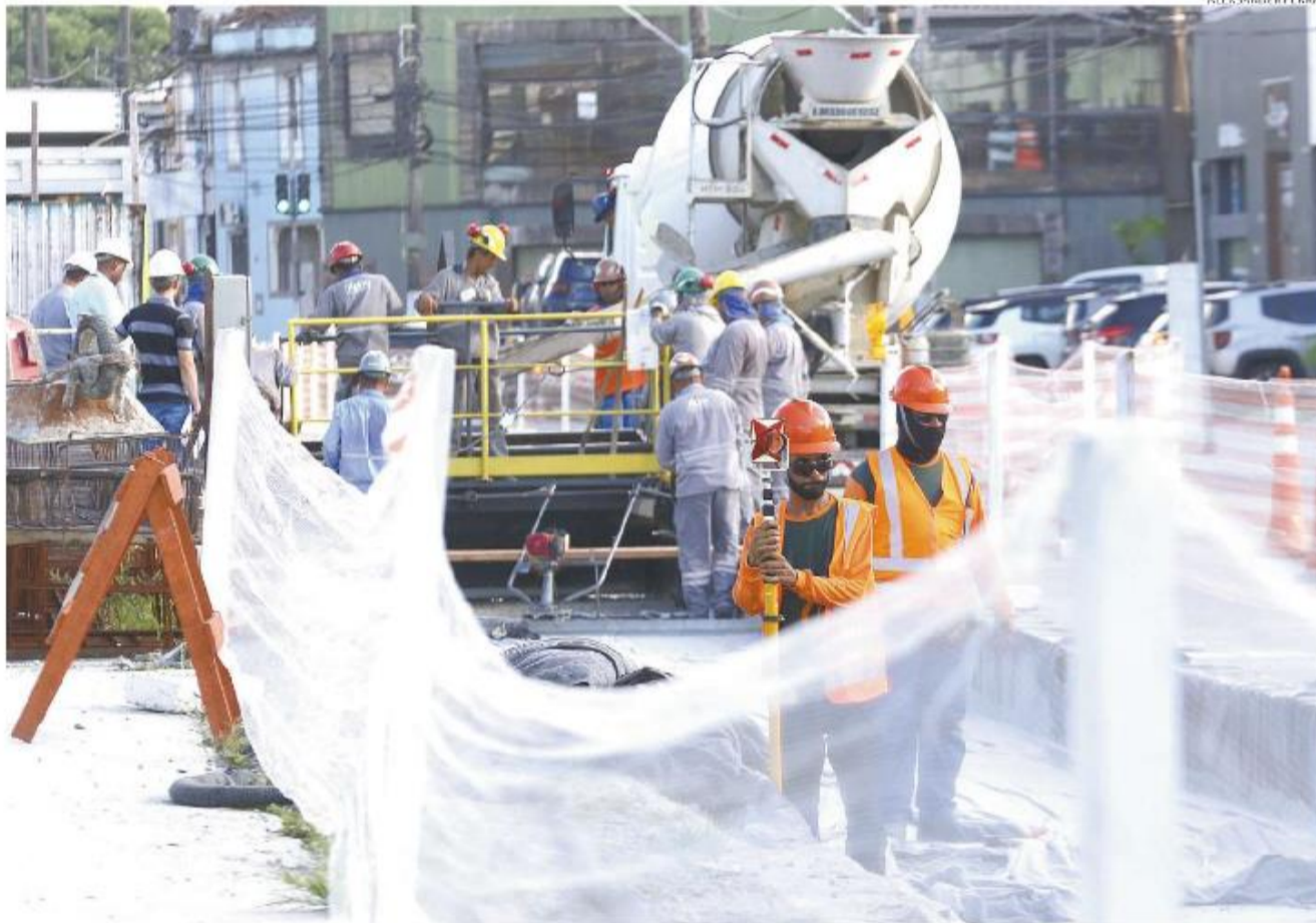
Conclusão das obras do VLT foi anunciada para julho do ano que vem. Cetesb multou construtora e EMTU, que está contestando a penalidade
