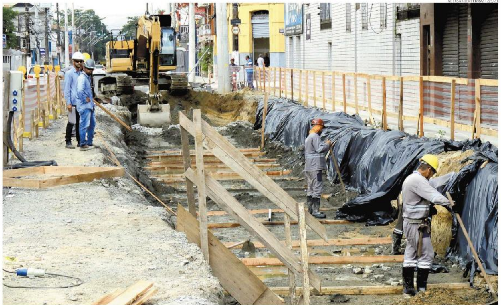
Foco principal está em acelerar obras do Veículo Leve sobre Trilhos em logradouros prioritariamente comerciais, em especial na Rua Campos Mello, do Macuco à Vila Mathias
