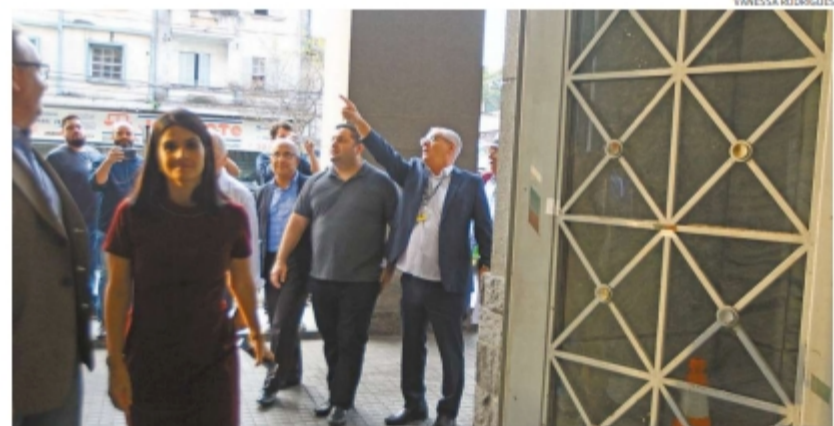
De longe dá para enxergar alguns dos problemas no prédio do Palácio da Polícia. Nas paredes laterais, brotam samambaias de vários tamanhos. Ainda na fachada, aparecem muitas infiltrações. O local tem estrutura para garantir a segurança de pedestres, mas ela já tem sinais de desgaste.
